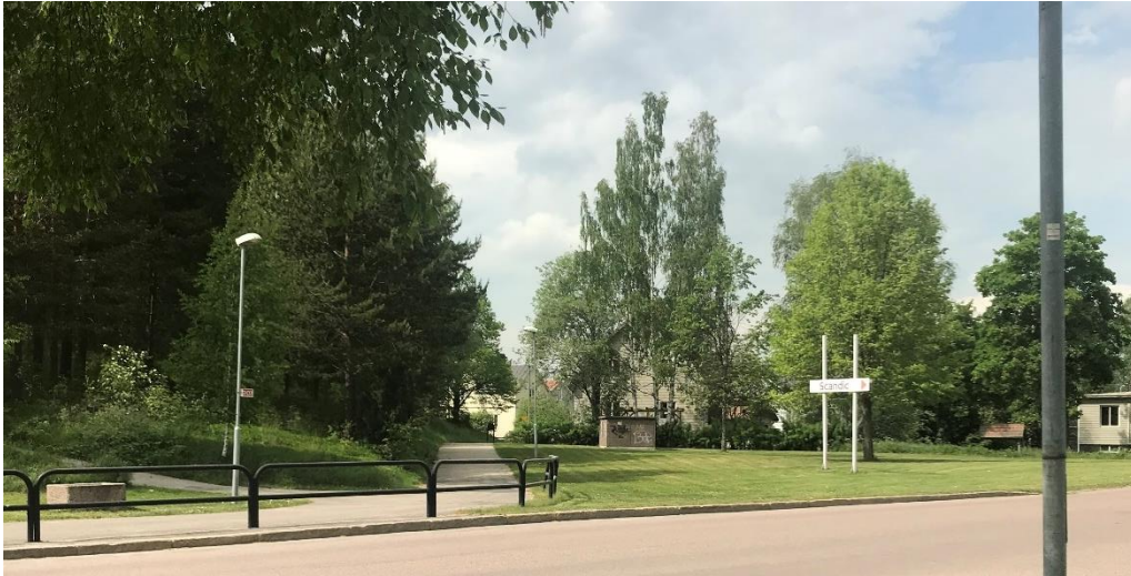
Fotot visar gång- och cykelväg fd Villagatan samt befintlig nätstation anlagd på fastigheten
